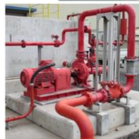
屋外消火栓設備
