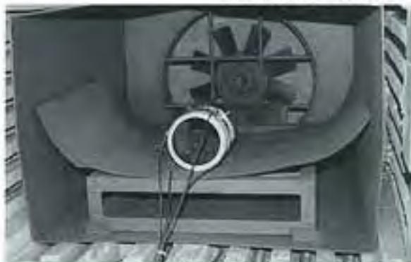
実材検定(バッチ式熱処理炉)
