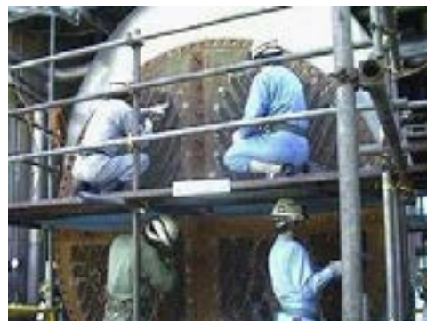
図2 熱交換器用伝熱管の内挿ET
