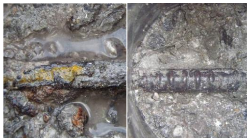
写真3 鉄筋の腐食状況確認
