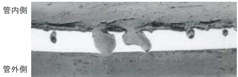
図12.浸食(破孔)部の断面状況(水流→)
