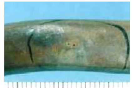
図10.銅管の浸食(破孔)部の外観
